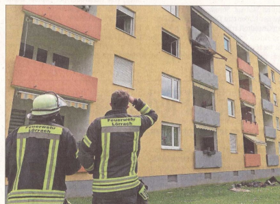
Feuerwehrmänner blicken auf den ausgebrannten Balkon, auf dem Rasen liegen verbrannte Gegenstände aus der Wohnung.
